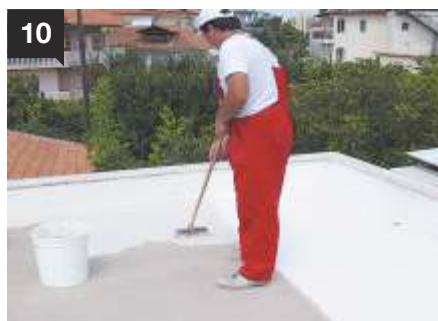
10 Ακολουθεί τρίτη στρώση με λευκό AQUAMAT-ELASTIC σταυρωτά με την προηγούμενη και αφού αυτή έχει στεγνώσει. Το πάχος κάθε στρώσης δεν πρέπει να ξεπερνάει το 1 mm.
