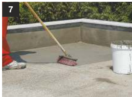
7 Γίνεται η πρώτη επάλειψη του AQUAMAT-ELASTIC με βούρτσα, σε λωρίδες πλάτους του 1 m. Η επάλειψη επεκτείνεται και στα κατακόρυφα στοιχεία (στηθαία κτλ.) κατά 15-20 cm.
