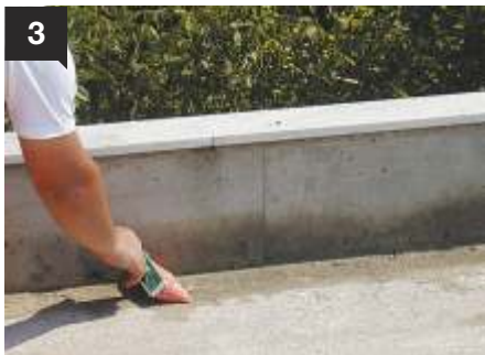
3 Η γωνία που σχηματίζεται στη συμβολή της πλάκας με κατακόρυφα στοιχεία (π.χ. στηθαία, απόληξη κλιμακαστασίου κτλ.) διαβρέχεται.
